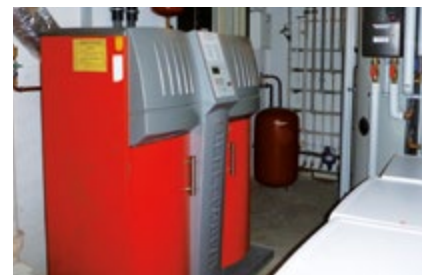
Heizzentrale mit Holzpelletkessel
